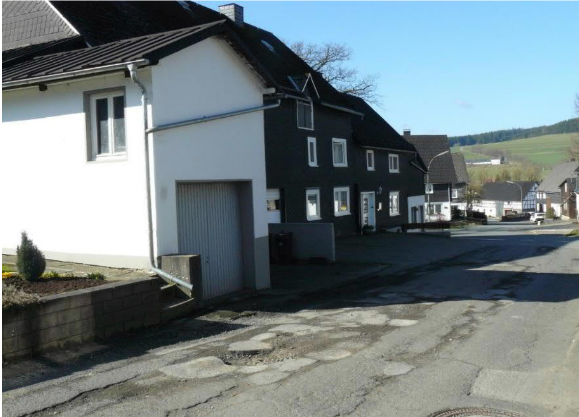
Abbildung 9: Grobelweg, Zustand der Straßenoberfläche und Hausvorfläche von Haus-Nr. 1
