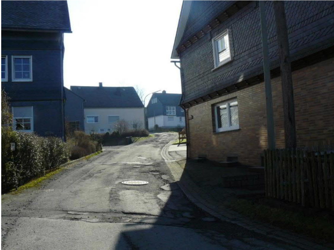
Abbildung 5: Bornlochweg auf Höhe Haus-Nr. 3, Zustand der Straßenoberfläche und Hausvorflächen
