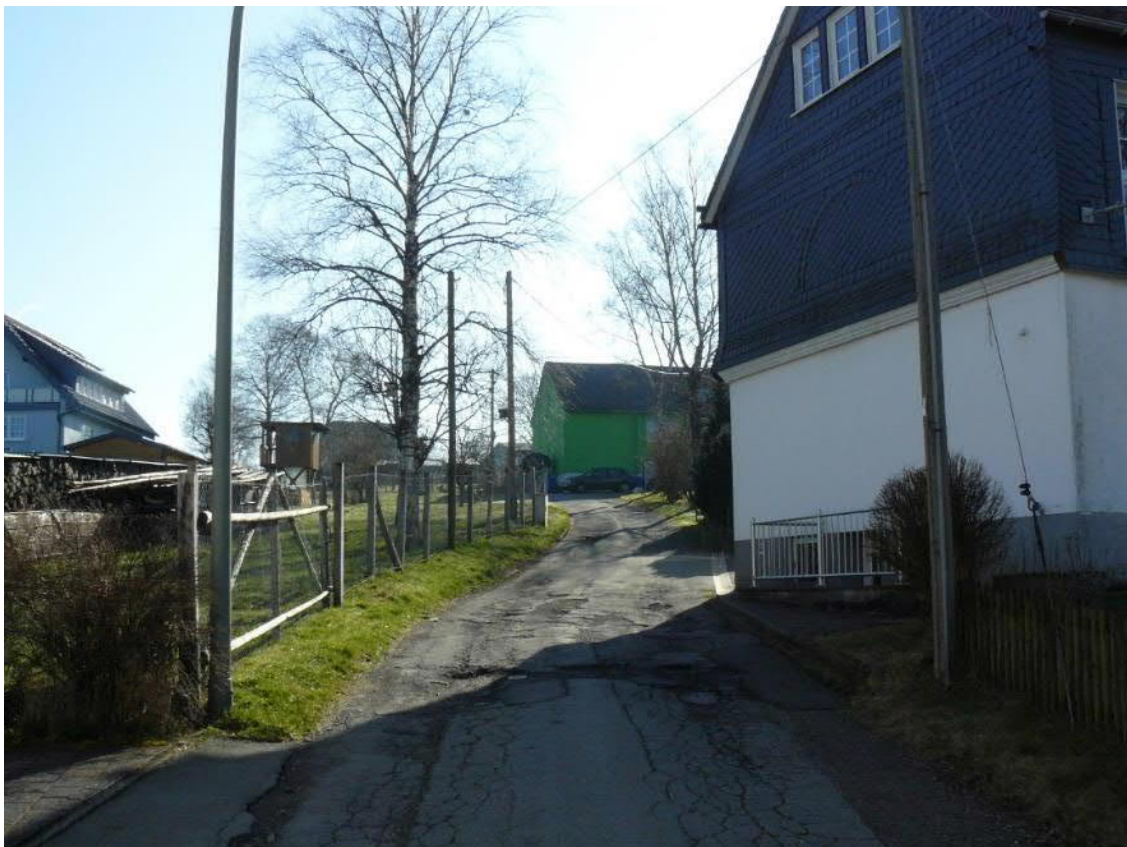
Abbildung 6: Bornlochweg, Zustand der Straßenoberfläche und Hausvorfläche von Haus-Nr. 7
