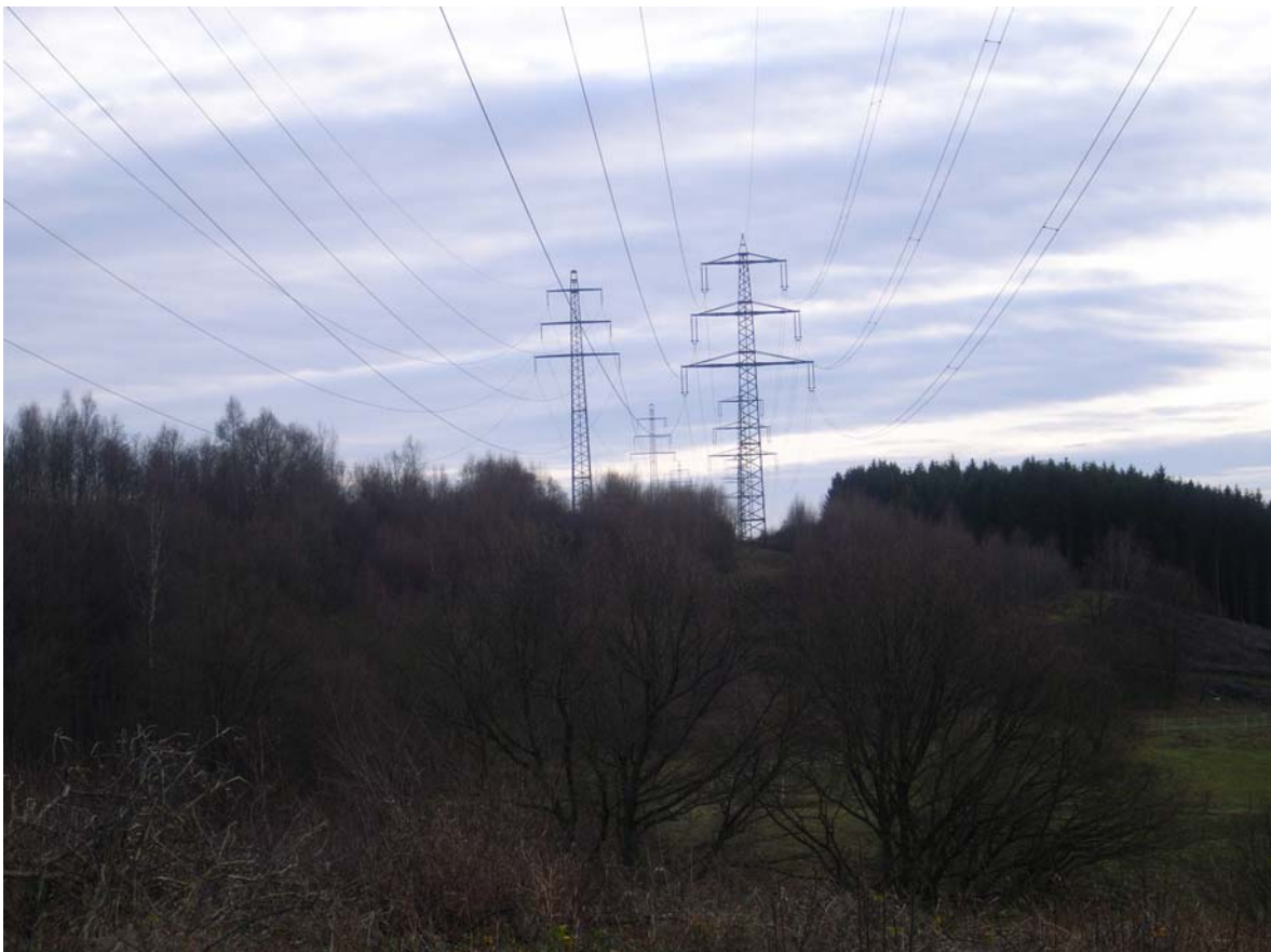
Abb. 2 Bestehende Hochspannungsleitung im FFH-Gebiet „Heiden und Magerrasen Trupbach“ (DE-5113-301)
