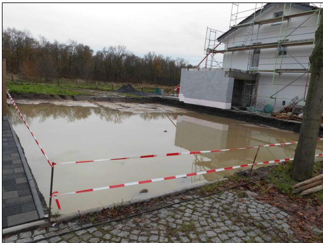
Abbildung 4: Hoher Wasserstand in Baugrube
