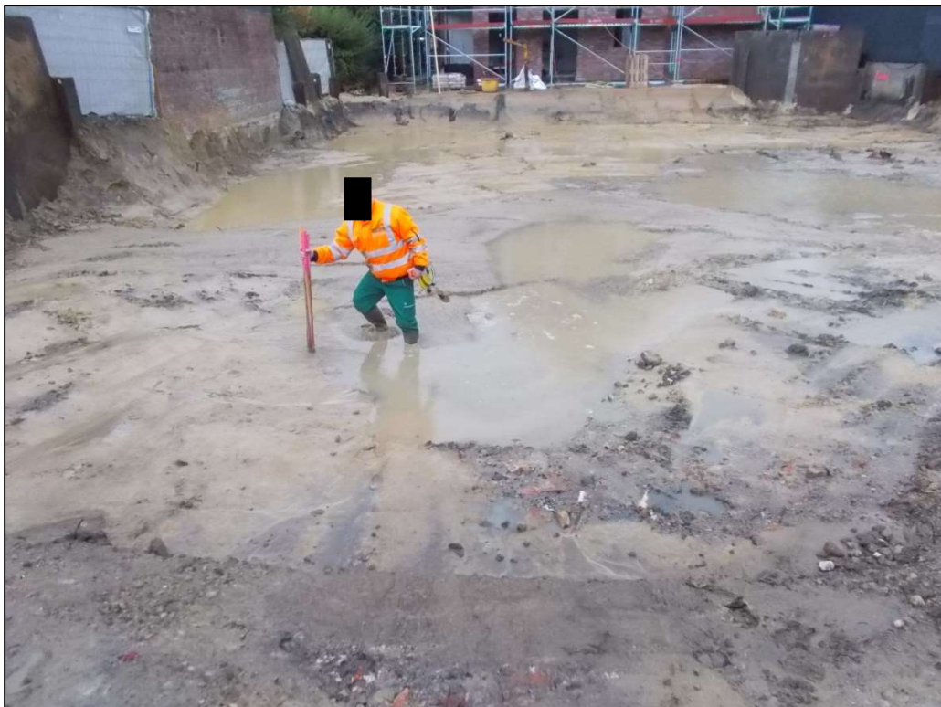
Abbildung 2: Verschlammte Sondierfläche, Bauschutt
