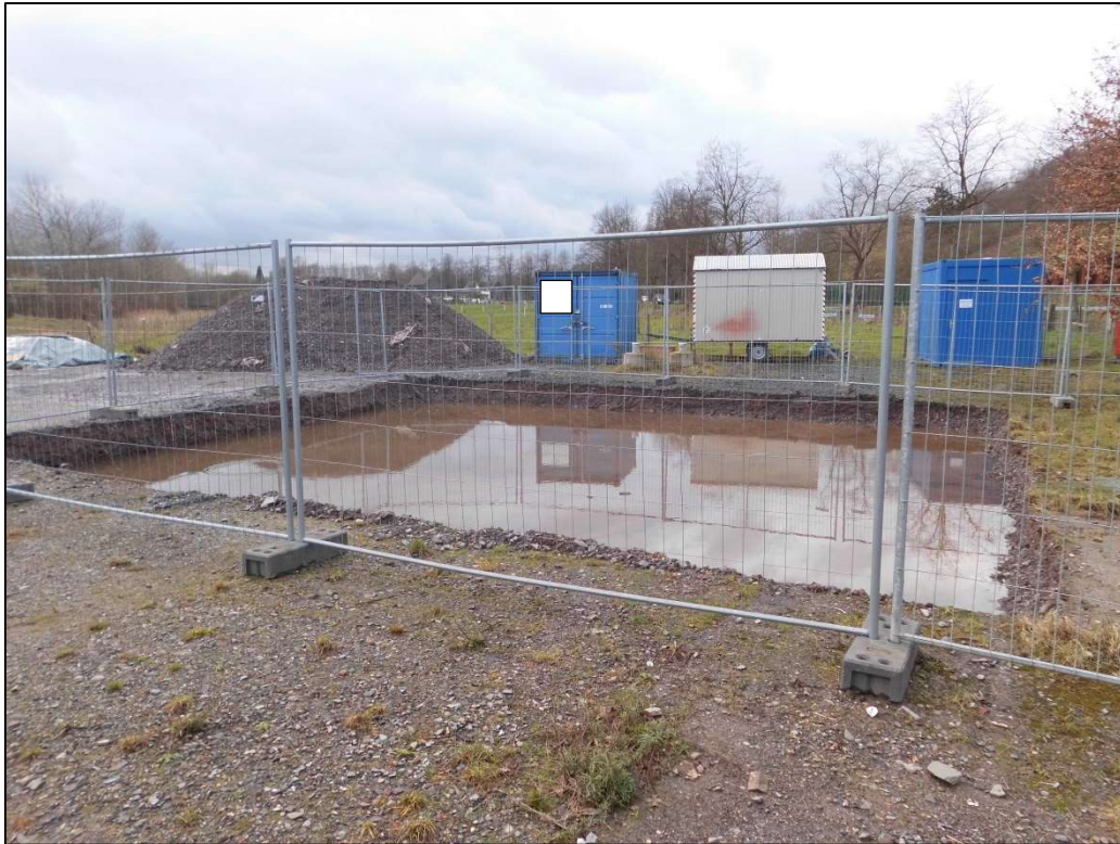
Abbildung 3: Hoher Wasserstand in Baugrube
