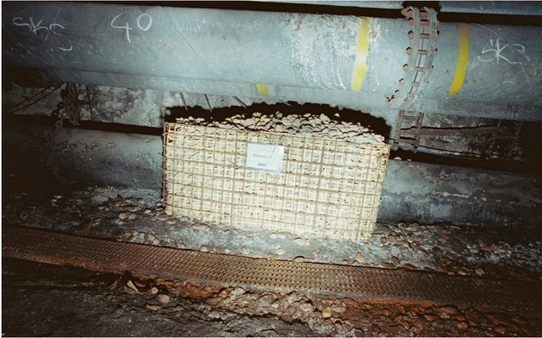
Abb. 19: Rohrleitung DN 500 mit Unterbrechungen und definierter Zutrittsstelle unter der Kiesschüttung (Foto: RAG)
