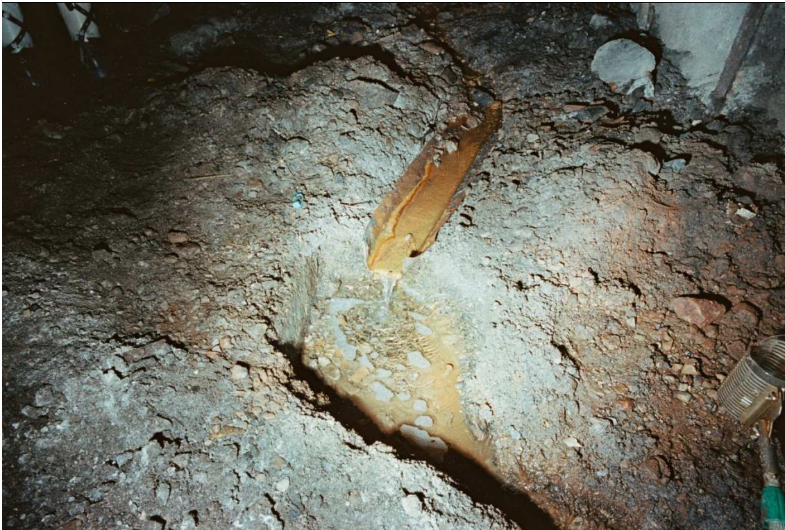
Abb. 65: Beispiel für ein offenes Gerinne mit Erosionspotential in der Zentralen Wasserhaltung Haus Aden, Betriebsbereich Haus Aden/Monopol (Foto: RAG)
